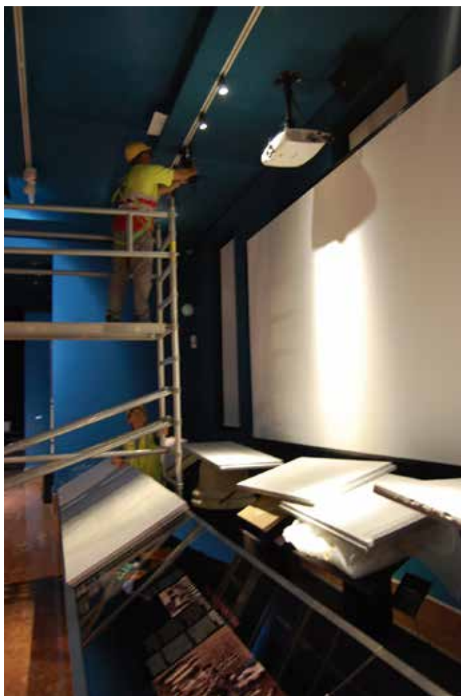
Figura 14.- Cambio del antiguo sistema de luces de sala por proyectores de LED para evitar entre otros los rayos ultravioletas (Archivo MARQ)
