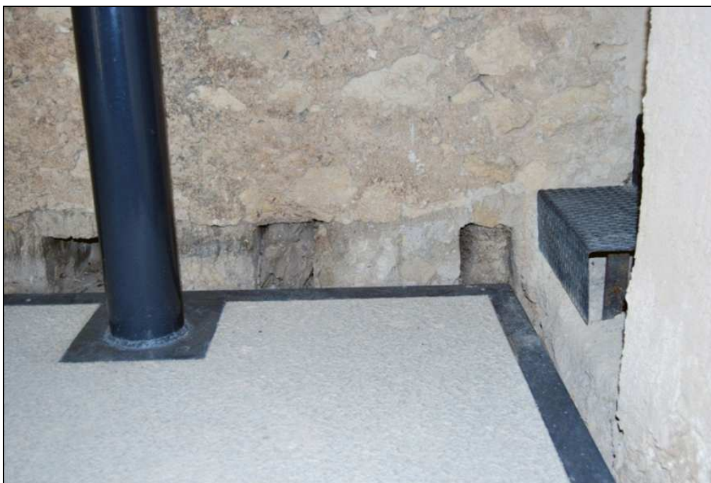
Restos de las vigas de madera. 2ª planta del palau.
