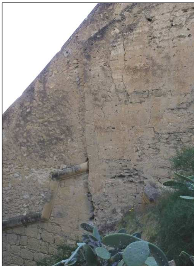
Tercera fase, siglo XVI. Se aprecia la moldura propia de la muralla y los baluartes de época renacentista.
