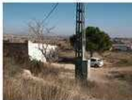
Foto 6: Vista de la posición de una torre de electricidad
