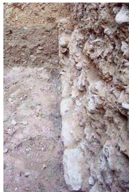
Detalle de la cara exterior de la muralla del XVI afectada
