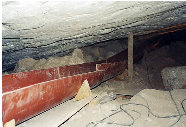
Otra vista del tubo de PVC
