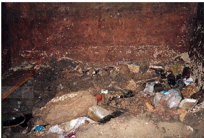
Detalle del interior del aljibe del patio central con la basura acumulada
