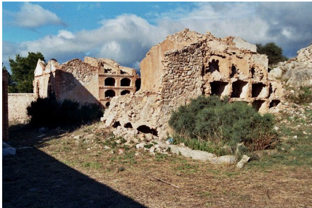
Estado del antiguo cementerio con posterioridad a la intervención de limpieza
