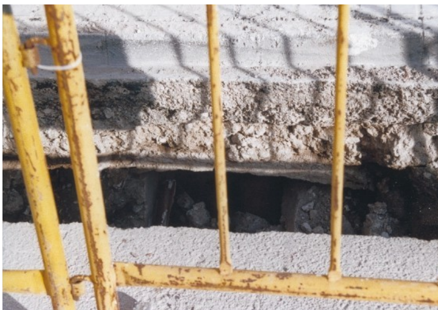
Pocetas de aguas negras en calle Maestro Caravaca
